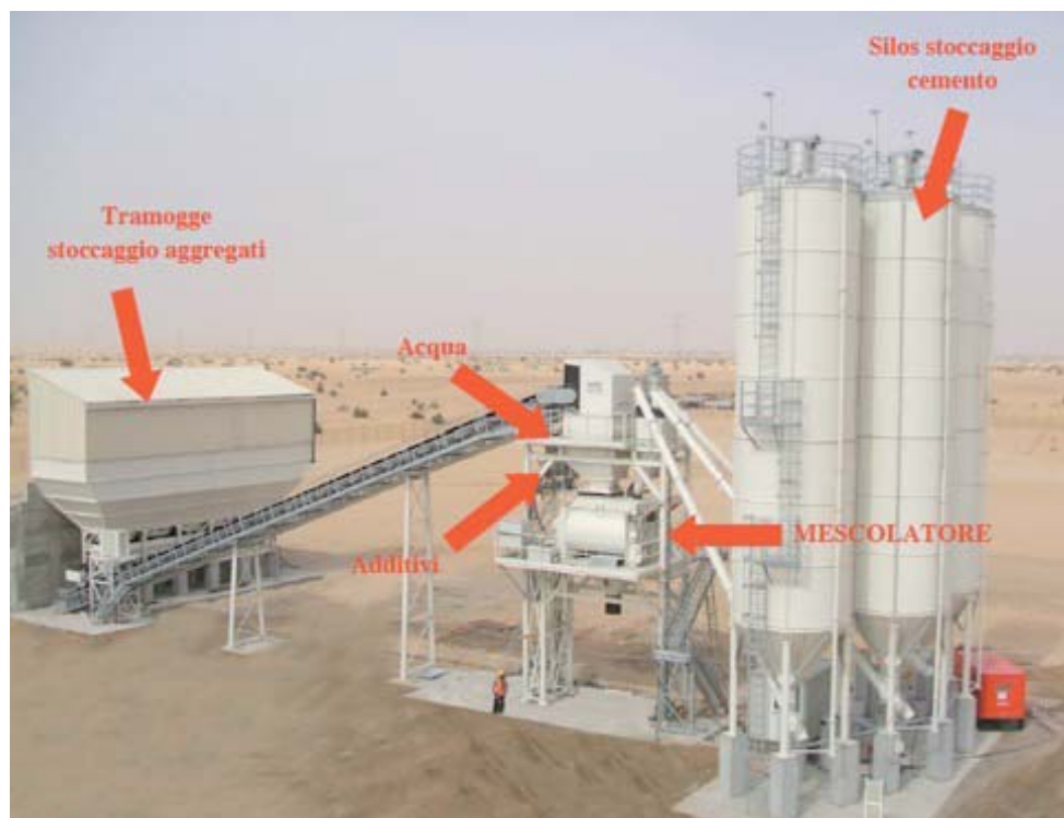
Centrale di betonaggio
